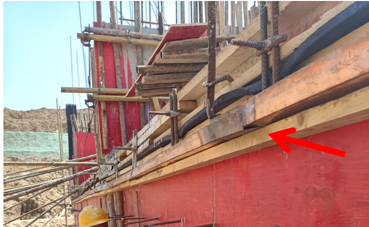
图 2 铜止水焊接接头未焊实
