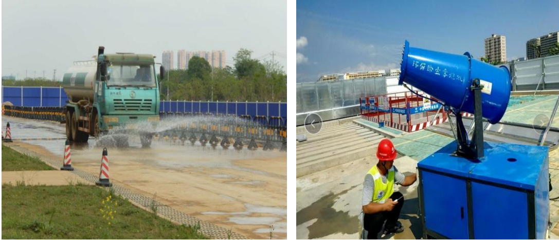
图 4.3.6-1 洒水降尘设施
