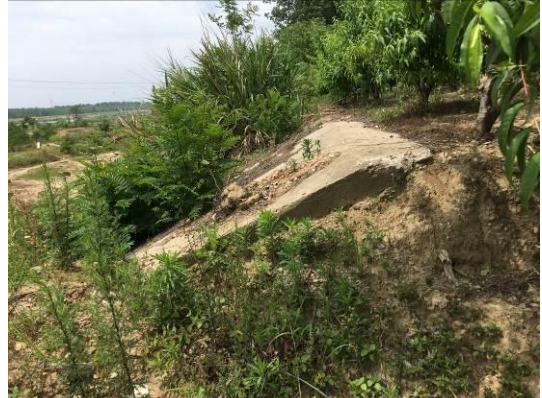
裕安区新沟险工
